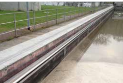
Längsräumer, im Becken montiert; Kläranlage Plauen Verfahrweg: 53 m
