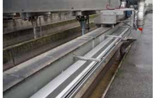
Sandfang; Kläranlage in Bamberg Verfahrweg: 26 m
