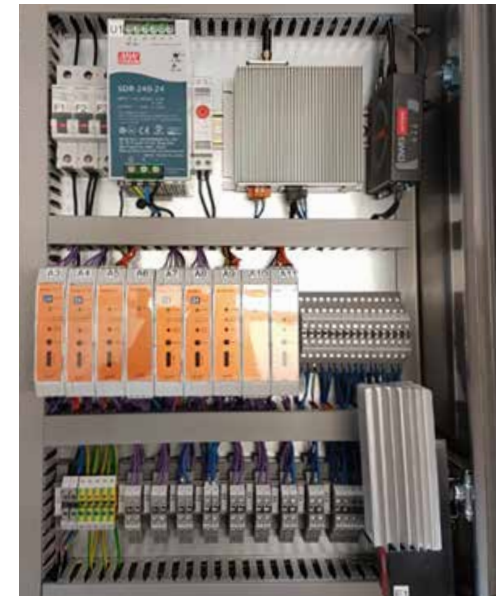
isense online-Installation im Schaltschrank
